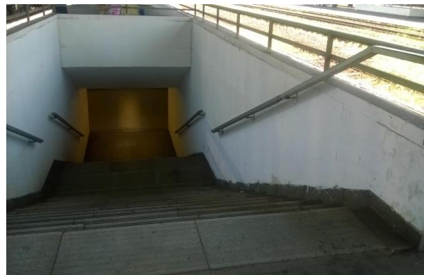
Lépcsőkar hiányzó látható jelölése és a fogódzó nem megfelelő kialakítása (folytonosság, keresztmetszet, kettős kasztkodó).
