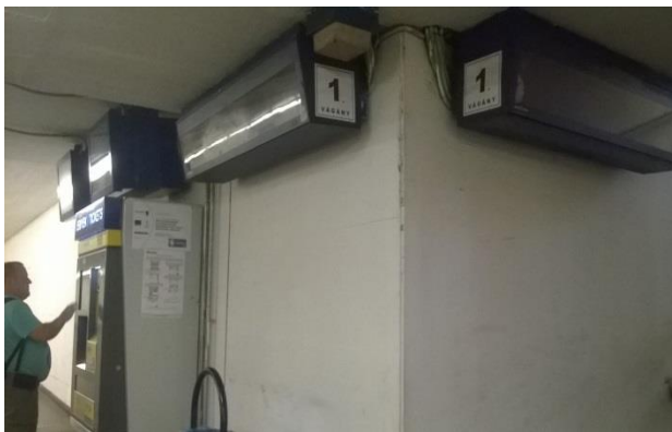
Vágányok nem megfelelően érzékelhető jelölése.
