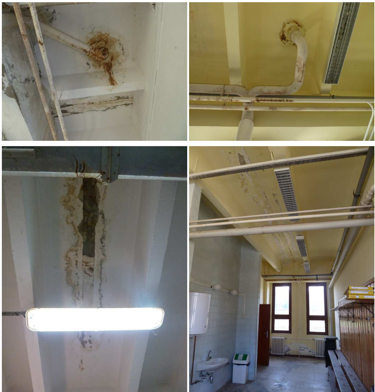
A SZOCIÁLIS ÉPÜLET ÖSSZEFOLYÓINAK KÖRNYEZETE ÉS A BEÁZÁSOK OKOZTA KÁROSODÁSOK
