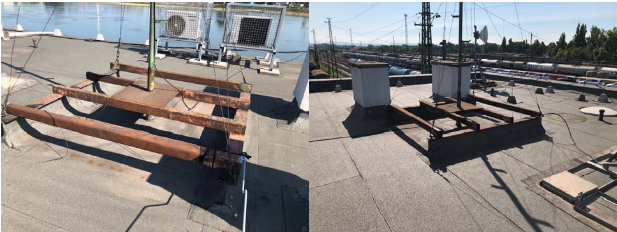
A csőátvezetés ami alatt korábban jeleztek beázást. A letámasztás acél tartószerkezete szigetelési szempontból megfelelő állapotban van. A középső csőátvezetés köpenycsővön áthatoló része viszont tömítési hiányosságot mutat. Vélhetően ezen keresztül korábban bejuthatott annyi nedvesség ami ilyen mértékű leázást okozhatott. Mivel a vizsgálat idején nem jelezték, hogy a közelmúltban itt tapasztaltak volna újbóli beázást, lehetséges ezt a hibaforrást időközben már javíthatták.
