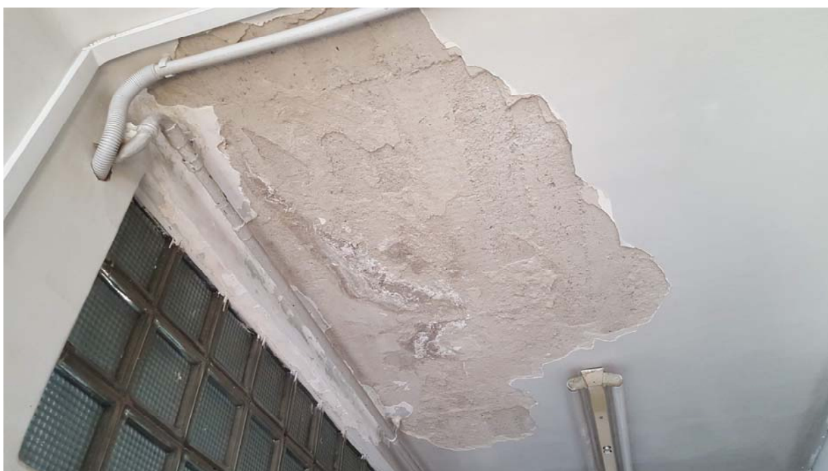
Az antennarúd födémáttörés alatti födémen is látható a korábbi beázási folt és a sókicapódás.
