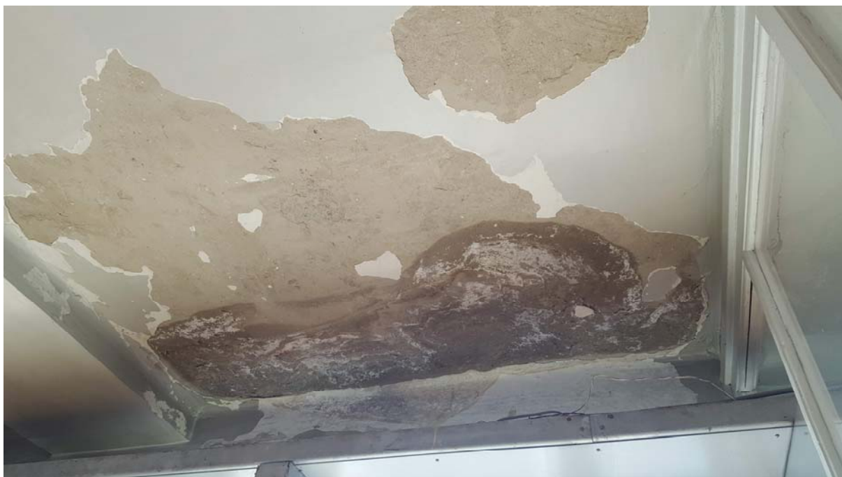
A K-i homlokzat attika falánál jeleztek korábbi beázást. Jelenleg a felülete sókivirágzásos, ami a kiszáradási folyamat egyik velejárója.
