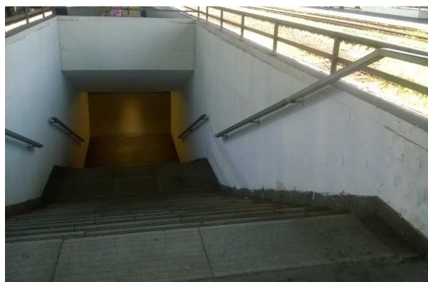
Lépcsőkar hiányzó látható jelölése és a fogódzó nem megfelelő kialakítása (folytonosság, keresztmetszet, kettős kapaszkodó).
