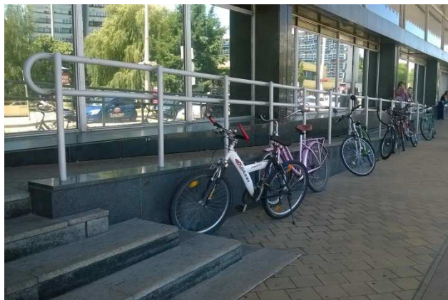
Előlépcsőnél hiányzik a kapaszkodó.
