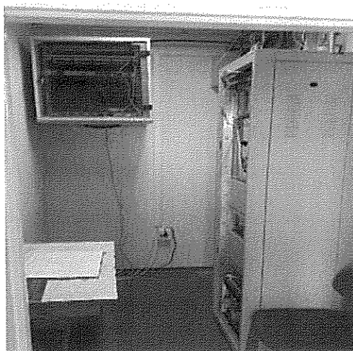
7. ábra Nyíradony állomás PMLI épületében lévő szerelvénytér
